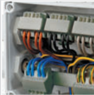
Много места для прокладки кабеля: Под дин-рейкой и между клеммниками
